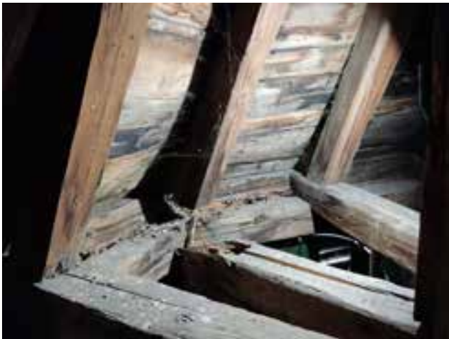
Ein Teil der vermoderten Balken im Dachstuhl des Turms
